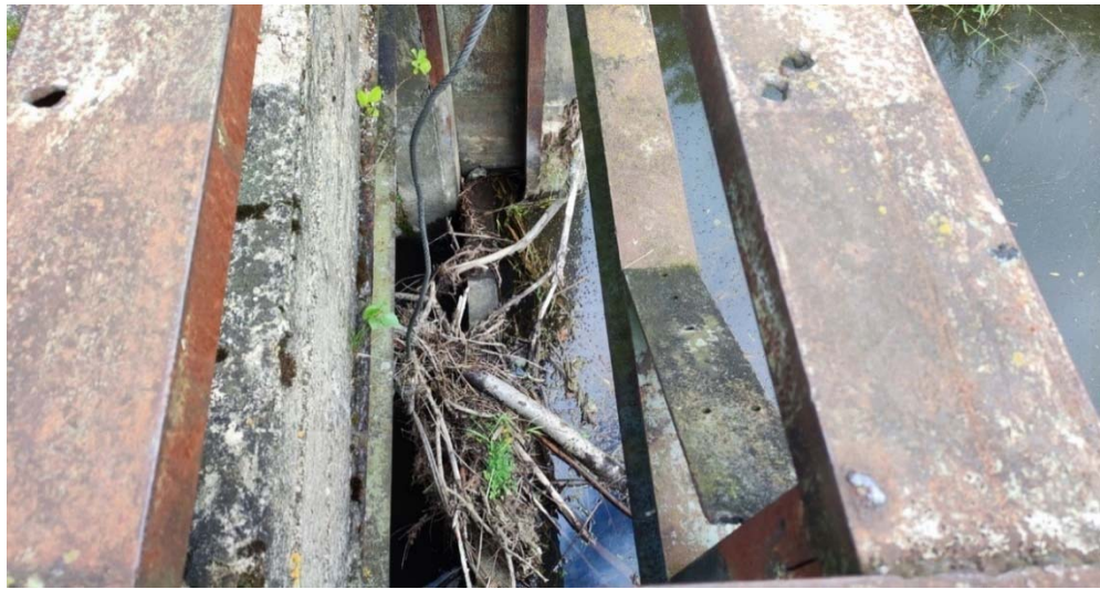
Рисунок 1 – Состояние шлюза-регулятора на реке Исlochь 29.07.2022 г.
